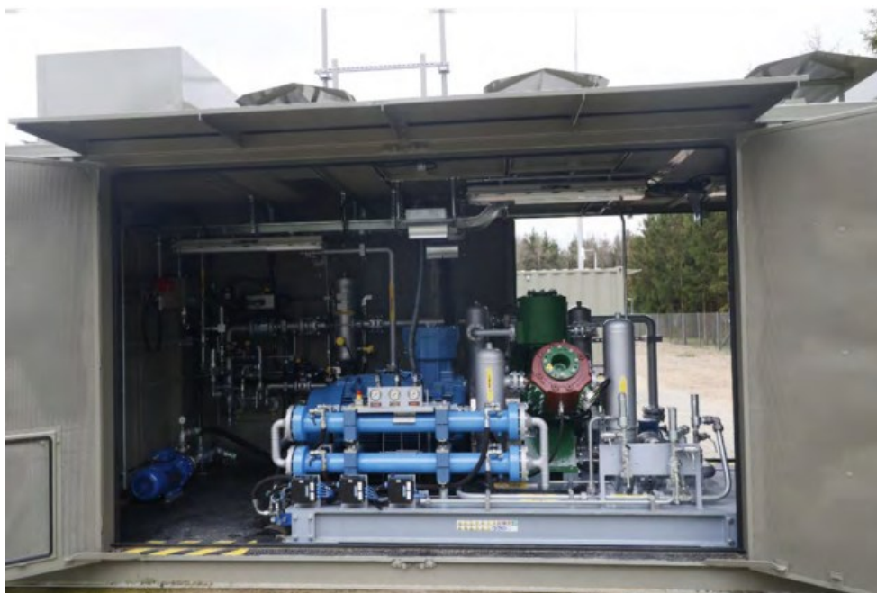
Figur 3 - Kompressor container med åbenstående kompressor rum.
